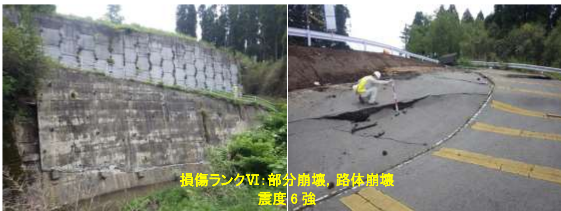
写真-4 損傷ランクVIの状況
