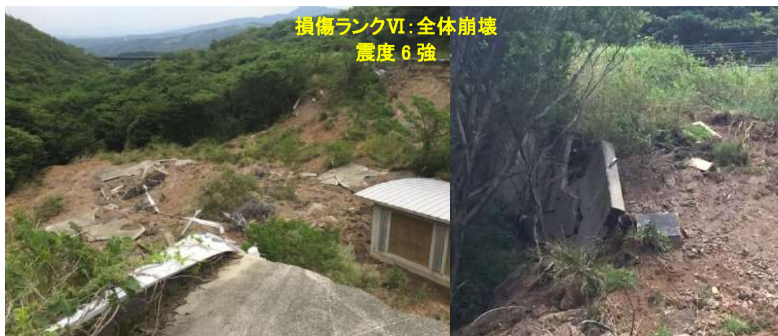
写真-5 損傷ランクVIの状況
