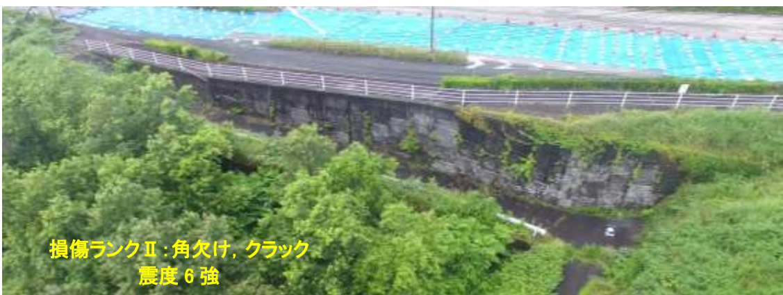
写真-6 損傷ランクIIの状況
