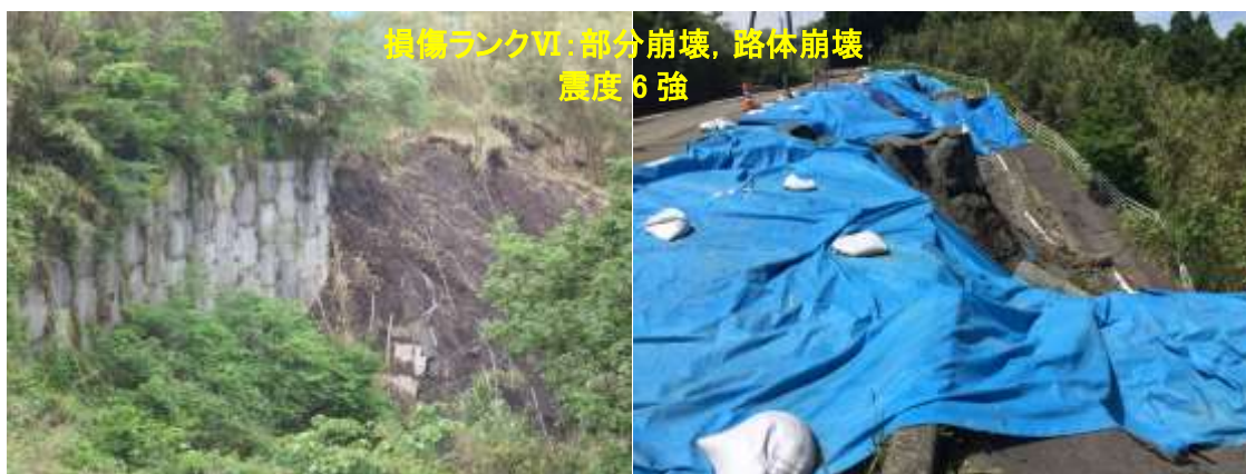
写真-3 損傷ランクⅥの状況
