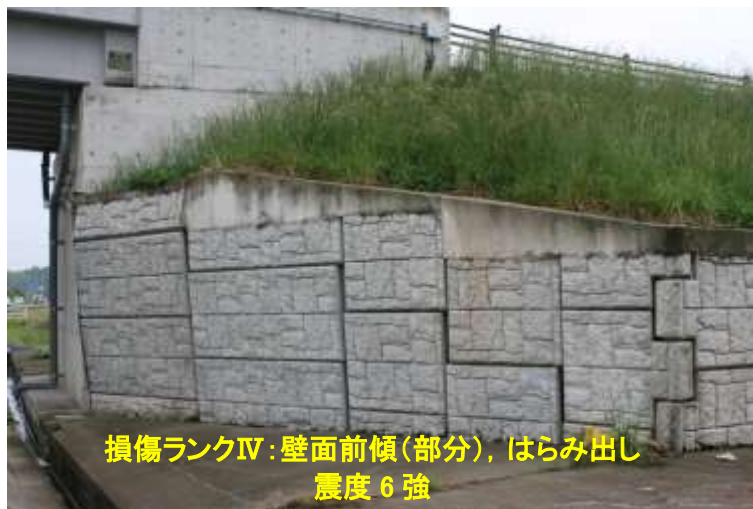
写真-1 震央より半径 5km圏内の状況
