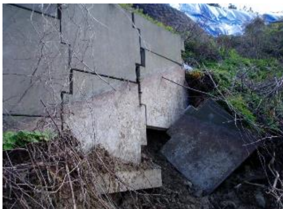
修復前 (被災直後)
